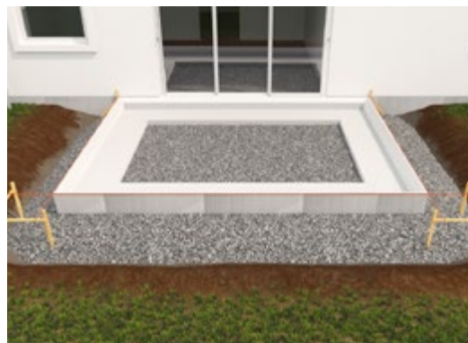
Placera ut Finja L-elementen längs murarsnöret.
